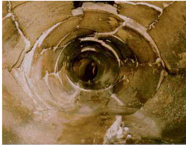
Multiple fractures in a clayware pipe – this is representative of the most severe damage that can be renovated using cured-in-place lining techniques Pişirilmiş kilde mamul bir boru içinde yer alan çoklu çatlaklar / yarıklar -
